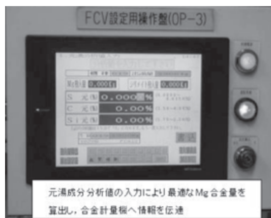
写真2 分析室に設置された元湯成分入力盤
